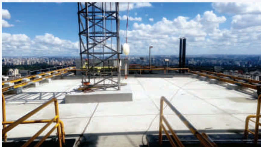
Citibank sede Paulista – Impermeabilização total da cobertura e heliponto – Av Paulista – São Paulo – SP
