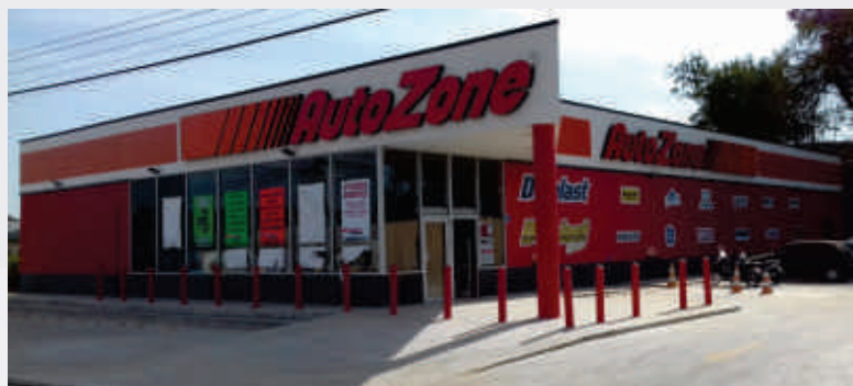
Autozone – Jaú/ SP Construção de edificação para implantação de loja com 700m 2 , além, de 700m 2 de jardim e 1627m 2 de urbanização incluso, pavimentação, calçamento e sinalização.
